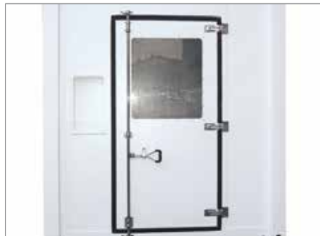
▲ Control panel door with lexan viewing window on the short side Ouverture coffret électrique avec fenêtre de visualisation en lexan sur côté court
