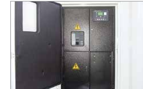
▲ Distribution board mounted on the long side of the generating set Coffret de distribution monté sur côté longue du groupe électrogène
