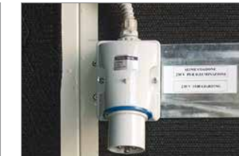
▲ Internal supply point 230V Point d'alimentation intérieure 230V
