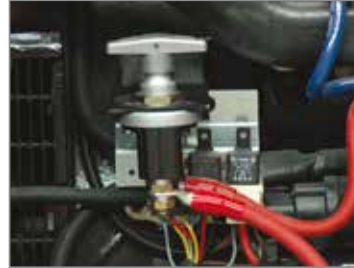
▲ Battery isolator switch Interrupteur coupe-batterie
