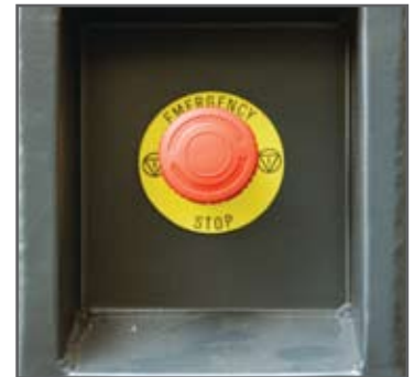
▲ Emergency stop button at both sides of the container Bouton d'arrêt d'urgence aux deux côtés du container
