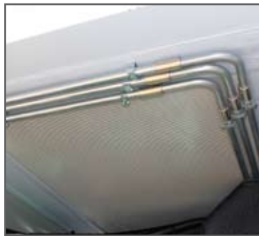
4 Flameproof lights system Système lumières antidéflagrant
