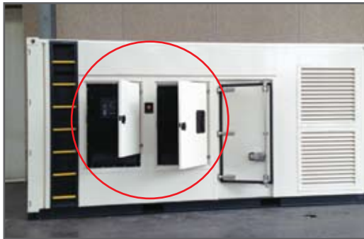
2 Controller and power bus bars are accessible from outside the container Le panneau de contrôle et les barres d'alimentation sont accessibles depuis l'extérieur du container.
