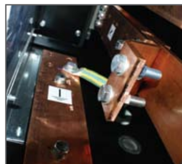
Grounding connection Mise à la terre
