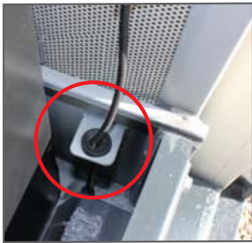
▲ Bund base alarm Alarme fuites bac de rétention
