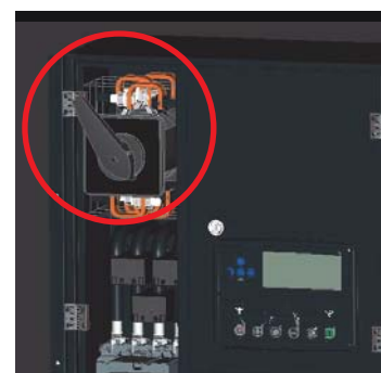
▲ 440-220 Volt switch Commutateur 440-220 V
