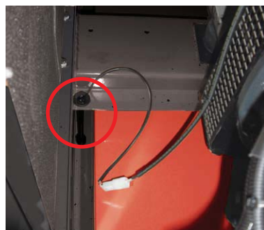
▲ Bund base alarm Alarm fuites bac de rétention
