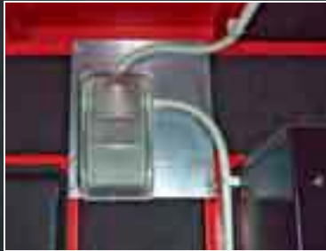
Internal lighting system Eclairage intérieur
